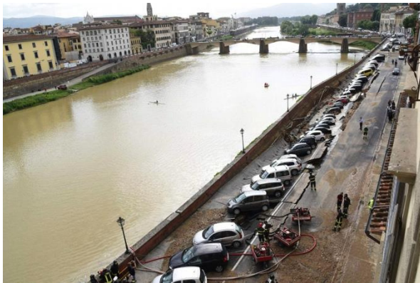
Figure 9 Arno Levee collapse - source Repubblica.it
